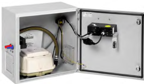
Armoire interne métallique
